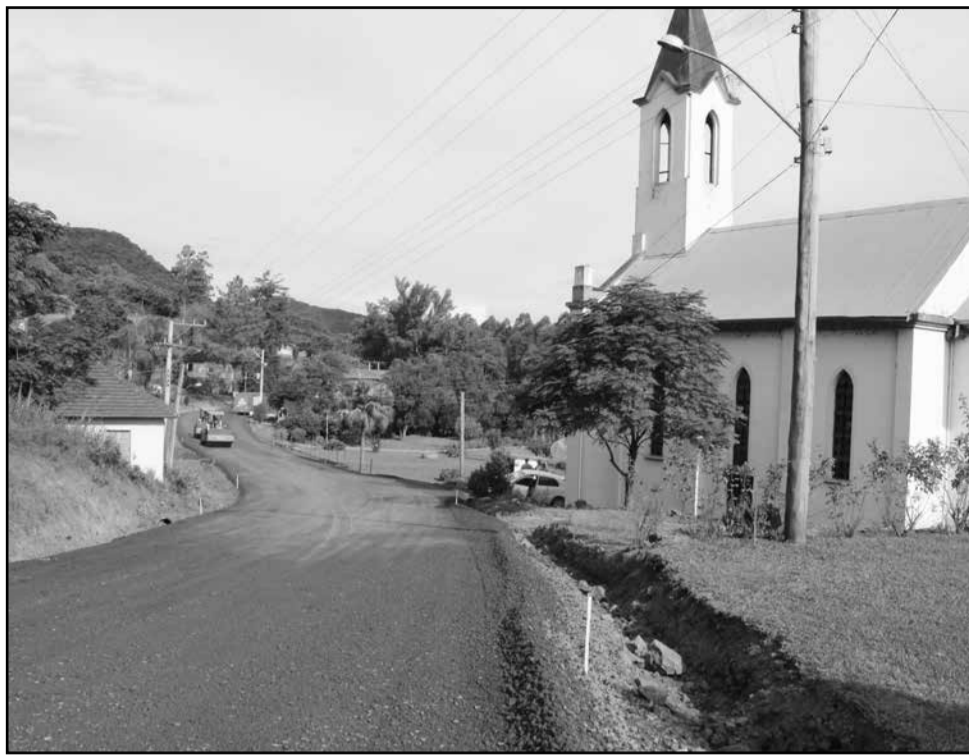
O asfalto está quase concluso, faltando obras de sinalização e drenagem ao lado do rodovia
